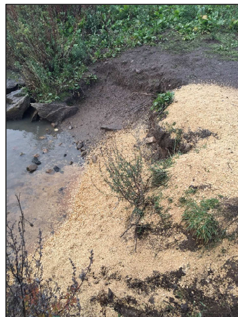
Figur 132: Andutmatning och erosion, Tomelilla 162
