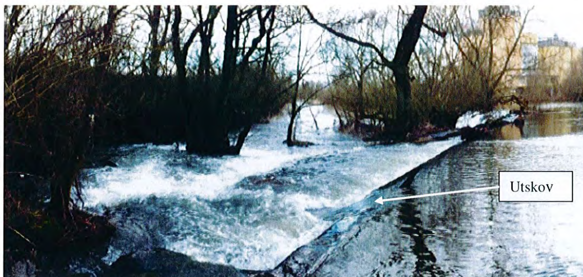
Figur 4.10 Fiskväg från 2010 med utskov i dammvall vid Farina AB. Foto tåget vid hög vattenföring. Källa: Ekoll AB.
