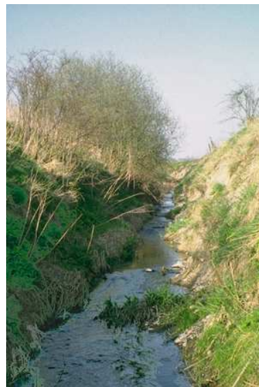
Figur 14. Branta dikeskanter ger risk för sättningar, ras och erosion.
