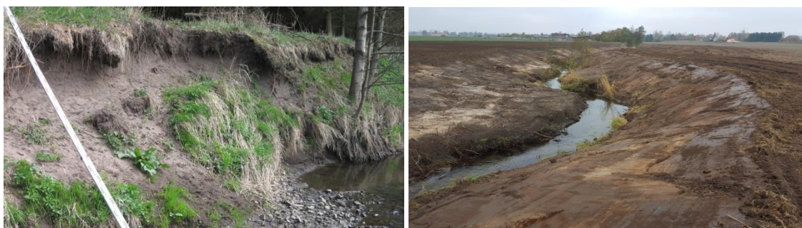
Erosionsbranter i Sularpsbäcken till vänster, före åtgärd. Avfasade slänter visas till höger.
