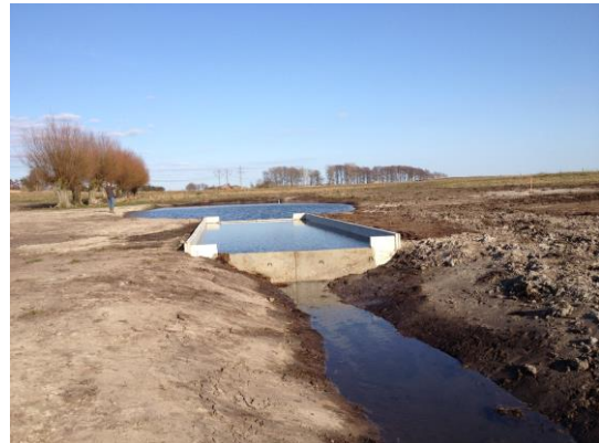
Kalkfilterbassäng i tillopp till våtmark vid Vikhög.
