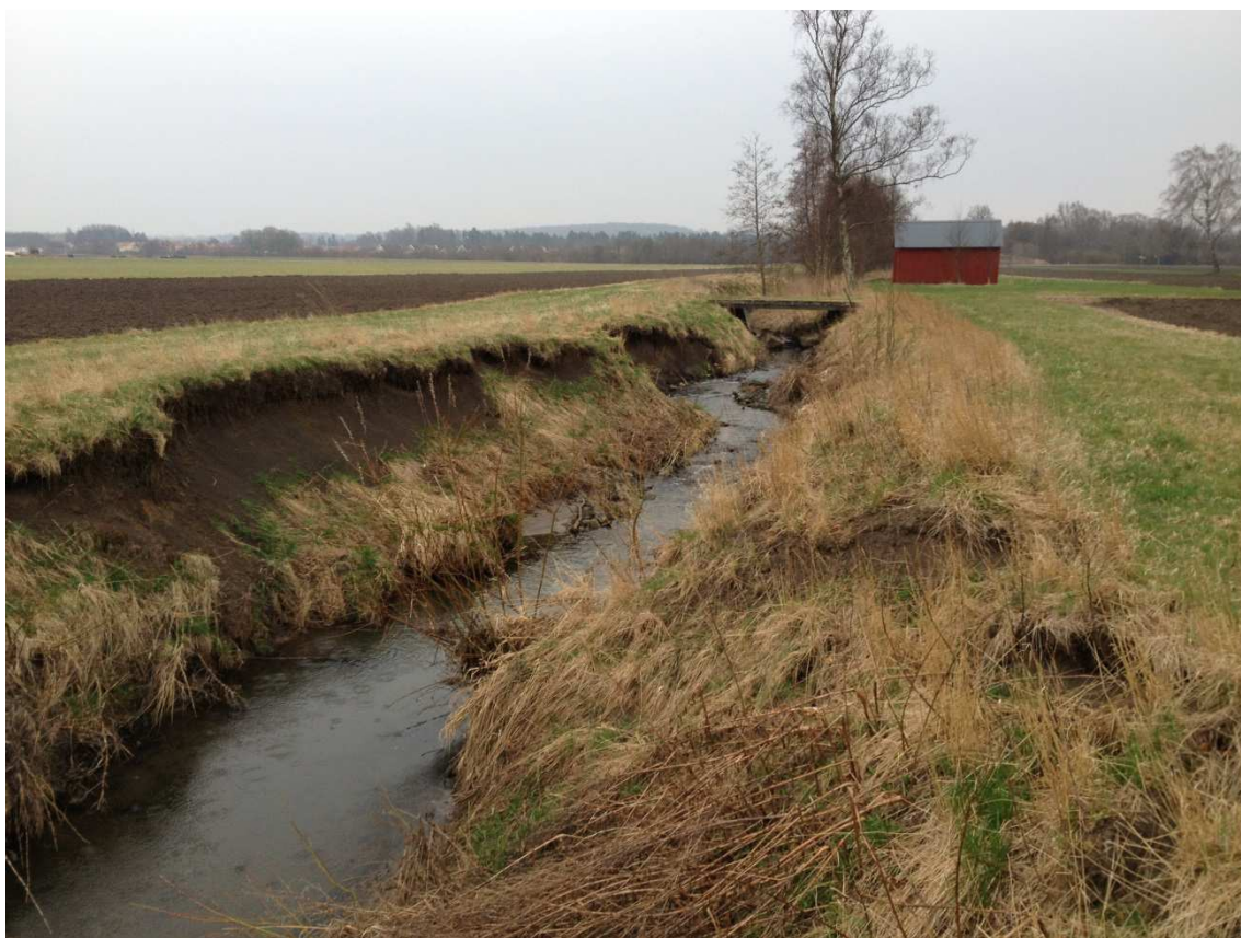
Figur 3. Erosion och rasbranter vid Sularpsbäcken nedströms Södra Sandby.
