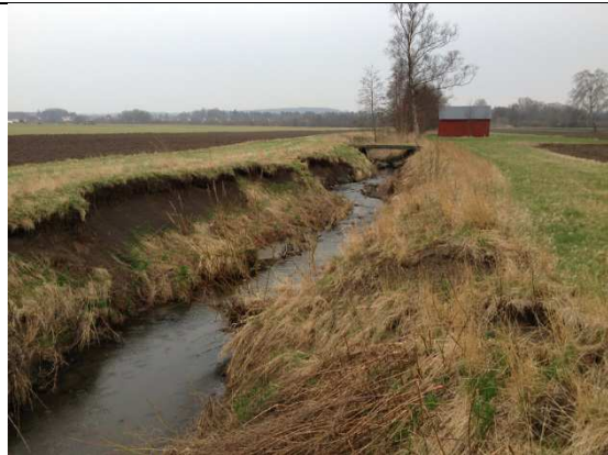
Exempel på ras och erosion längs Sularpsbäcken.
