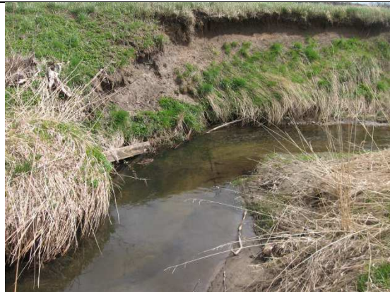
Exempel på ras och erosion längs Sularpsbäcken.
