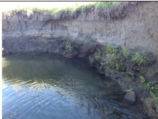
Exempel på ras och erosion längs Sularpsbäcken.
