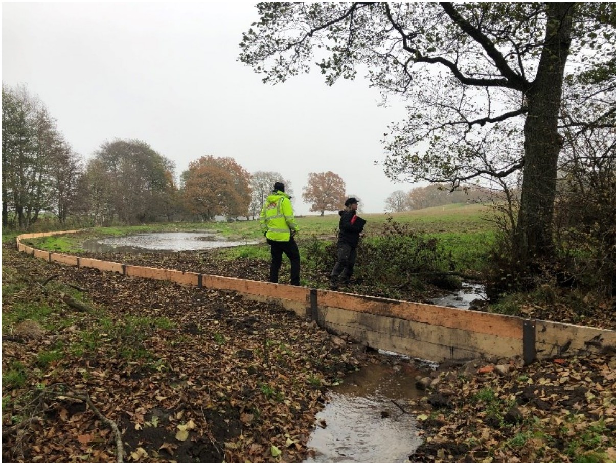
Figur 12 Vy över plankdämme och översvämningsyta på Vanstadtorp 10:12. Vid höga flöden sker en dämning av bäcken med hjälp av plankdämnet. Vid lägre flöden rinner vattnet under det dämmande planket. Bild Tette Alström, Ekologigruppen
