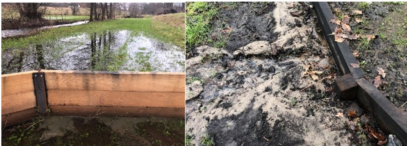
Figur 22 Plankdämnena vid läge 1 (th) och 4 (tv). Vattnet hölls inte helt på plats på grund av läckage mellan plank och mark
