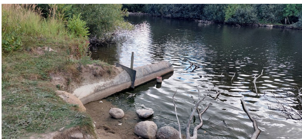
Figur 10 Ledning mellan bevattningsdamm och damm söder om. Ledningen var vid besöket avstängd med en platta enligt bild
