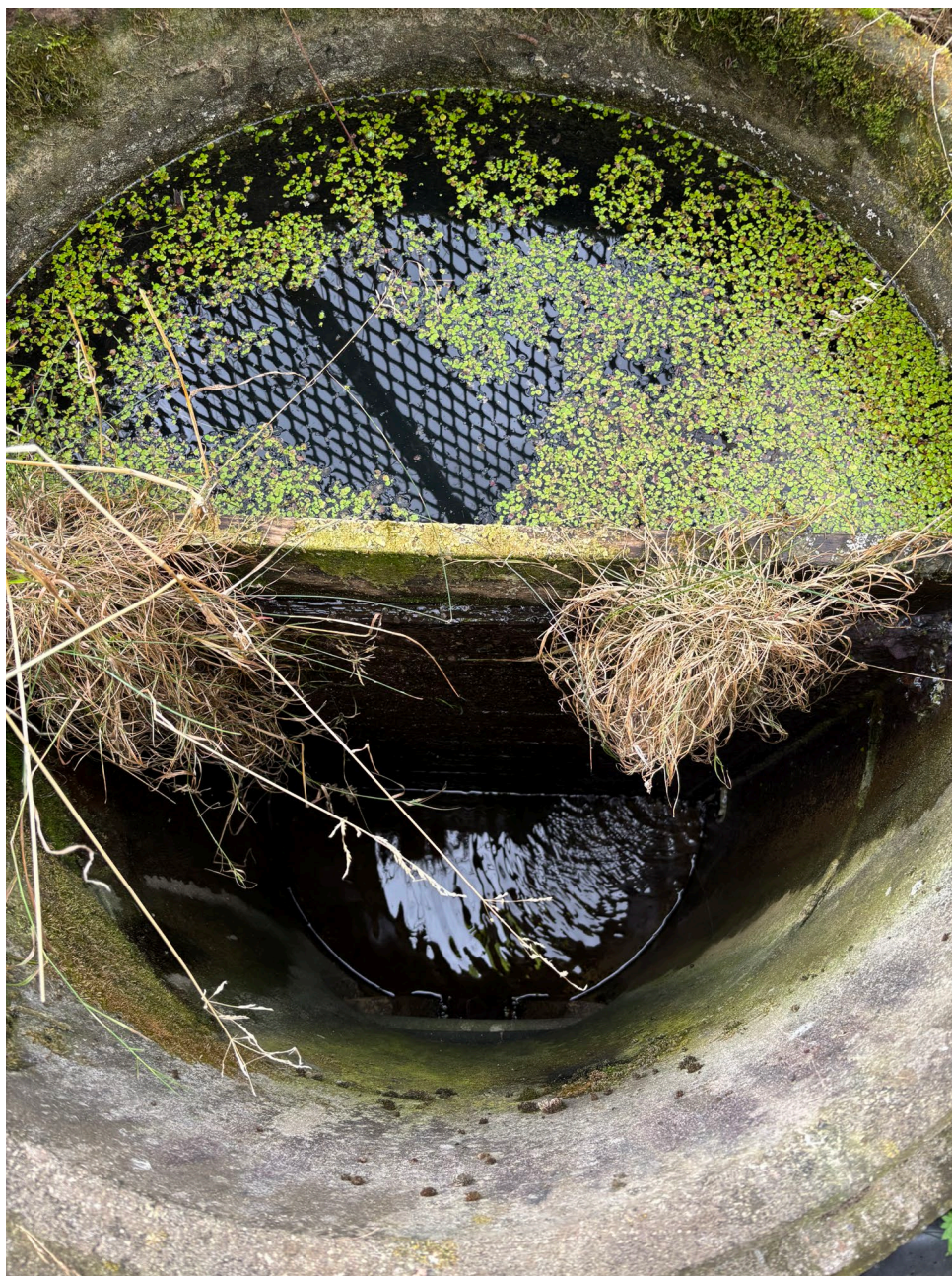
Figur 22 Utloppsbrunn med planksättare för våtmark K245. Översta planksätter hör inte till anläggningen. Vattenytan enligt planerat plank. Reglervolym >1 m ner till utloppsrör nedströms planksättare. 2026-08-21
